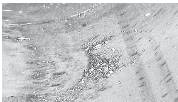
写真：40時間フラッシング後の配管内付着物例
