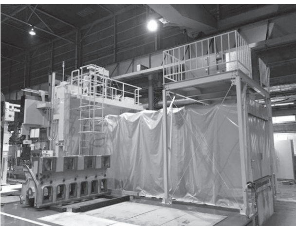
専用設計のドーム型集塵設備
